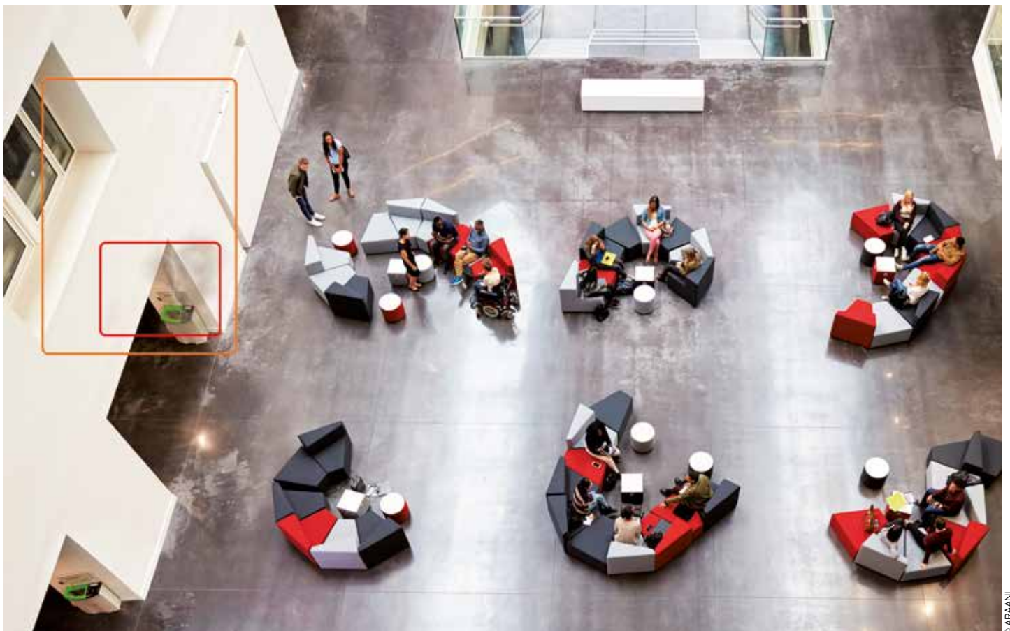
Dans un atrium, caméra détectrice de fumée SmokeCatcher Certified, développée par Araani.
